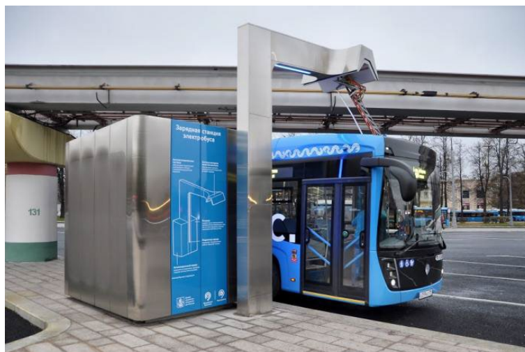
Рис. 2. Зарядка электробуса через пантограф Fig. 2. Charging the electric bus via pantograph
